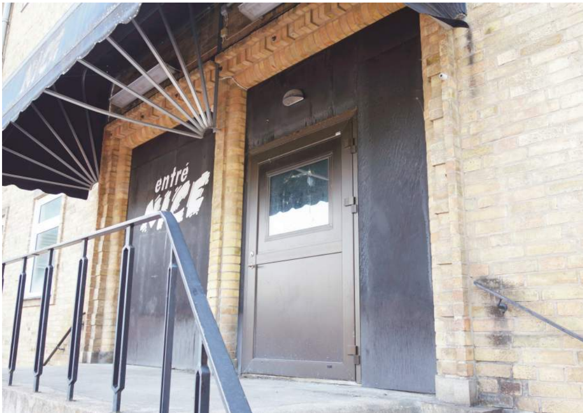
Mönstermurad tidigare huvudentré som är kraftigt förvanskad genom montering av skivmaterial och aluminiumparti i dörröppningar samt skyddande markis (Fredriksson arkitektkontor 2022).
