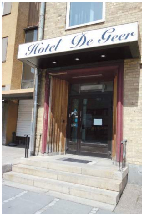
Ursprunglig och relativt välbevarad entré i södra fasaden. Dörrpartiet i aluminium är sekundärt men trappa, räcken och omfattning i ädelträ är original (Fredriksson arkitektkontor 2022).
