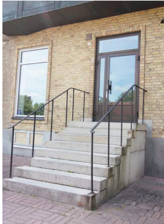
Norra entrén i östra fasaden. Trappa och räcke är ursprungliga medan dörrpartiet är sekundärt (Fredriksson arkitektkontor 2022).
