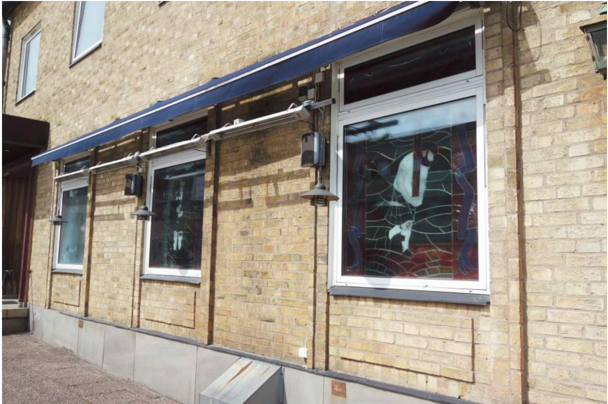
I murverket utkragade omfattningar och fyllningar under fönster i fasad mot söder. Markisen är sentida och har viss förvanskande verkan på fasaden (Fredriksson arkitektkontor 2022).
